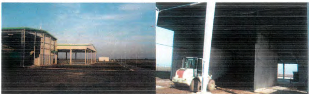
Stația de măcinare și compostare intensă
