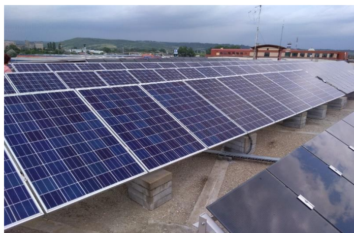
Figura 76. Imagine de prezentare panouri fotovoltaice
