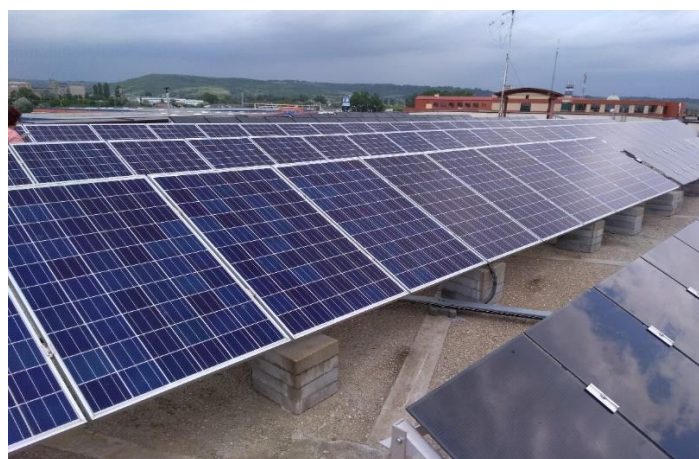
Figura 76. Imagine de prezentare panouri fotovoltaice
