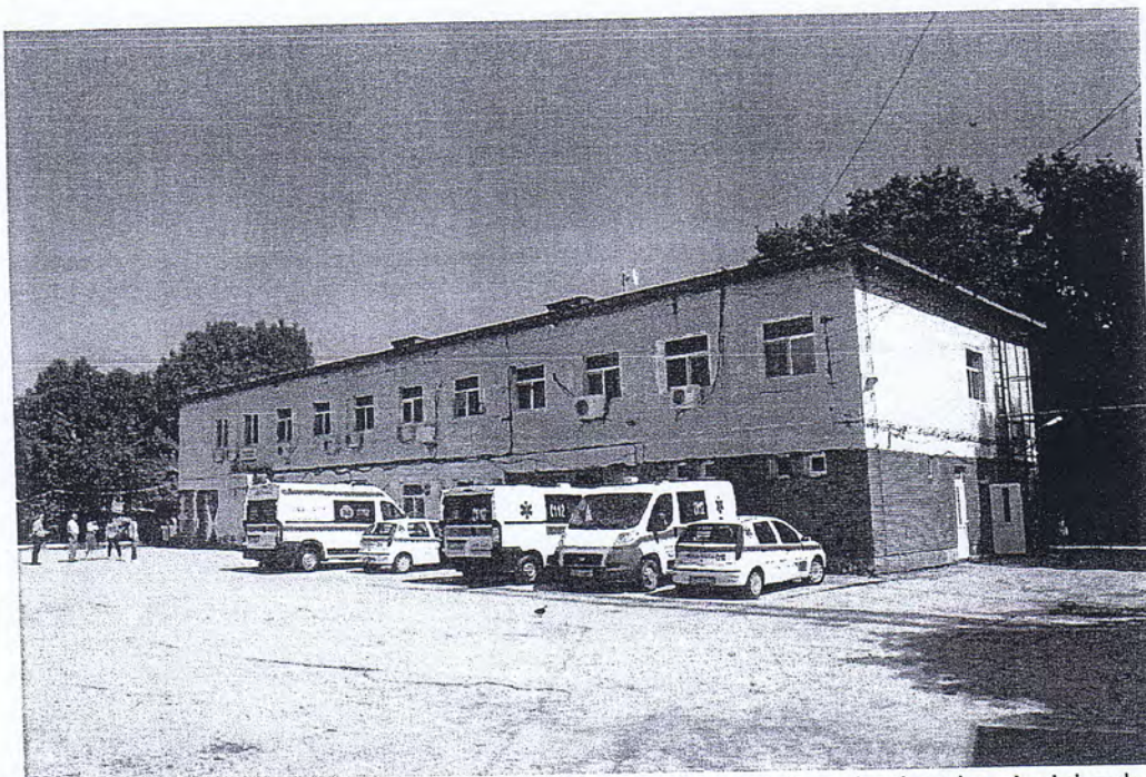
Fatada principala – Urme de degradare ale finisajelor fatadei, lipsa burlanelor si a jgheaburilor
